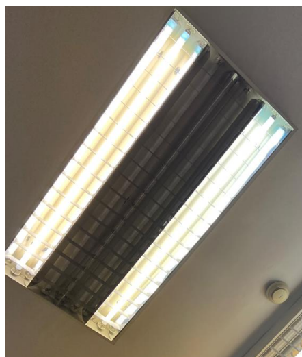
Slika 5. Prikaz postojeće rasvjete u spremištu
