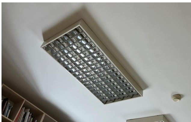
Slika 6. Prikaz postojeće rasvjete u knjižnici.
