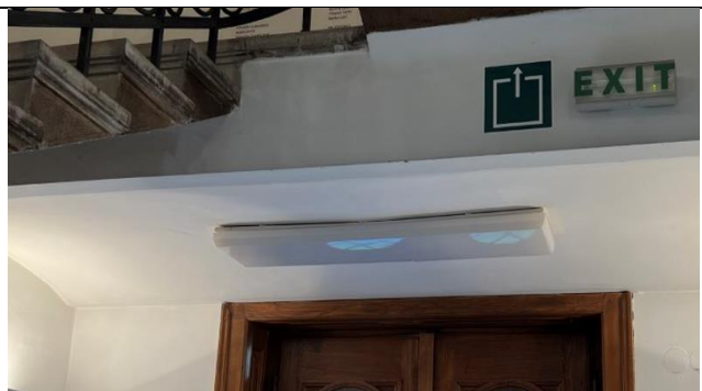
Slika 9. Prikaz postojeće rasvjete ispred ulaznih vrata
